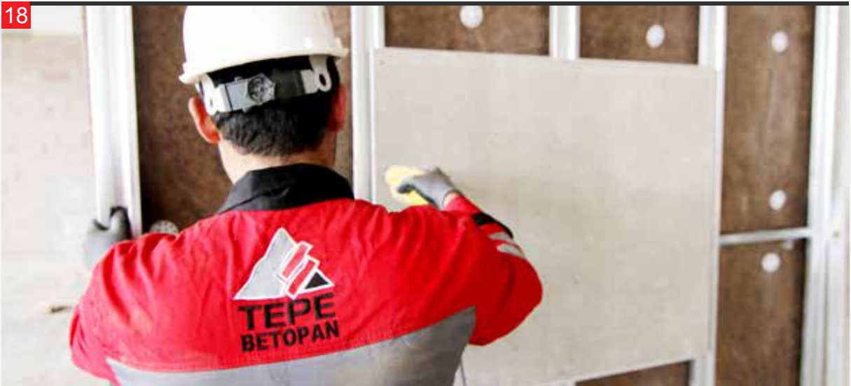
18 Vidalama esnasında levhaların alt ve üst kısımları vidalanırken, 2.5 cm'lik alt ve üst sınırdan pay bırakılarak vidalama yapılmalıdır.
